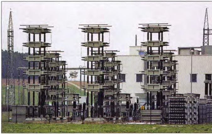
Oberwellenfilter der GKK Etzenricht (1999); die drei Türme im Vordergrund beherbergten die Kondensatoren, die zusammen 2360 nF Kapazität erbrachten. Die Widerstände waren in den großen Kästen untergebracht, die Spulen in den weißen Zylindern im Hintergrund.
