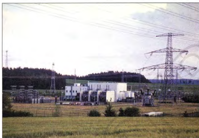
Die teilweise demontierte HGÜ-Kurzkupplung in Etzenricht, fotografiert am 30. 5. 98; die weiße Halle mit den drei Transformatoren an der Vorderseite beinhaltet den Stromrichter. Links von der Halle ist das einzige noch verbliebene Oberwellenfilter zu sehen.
